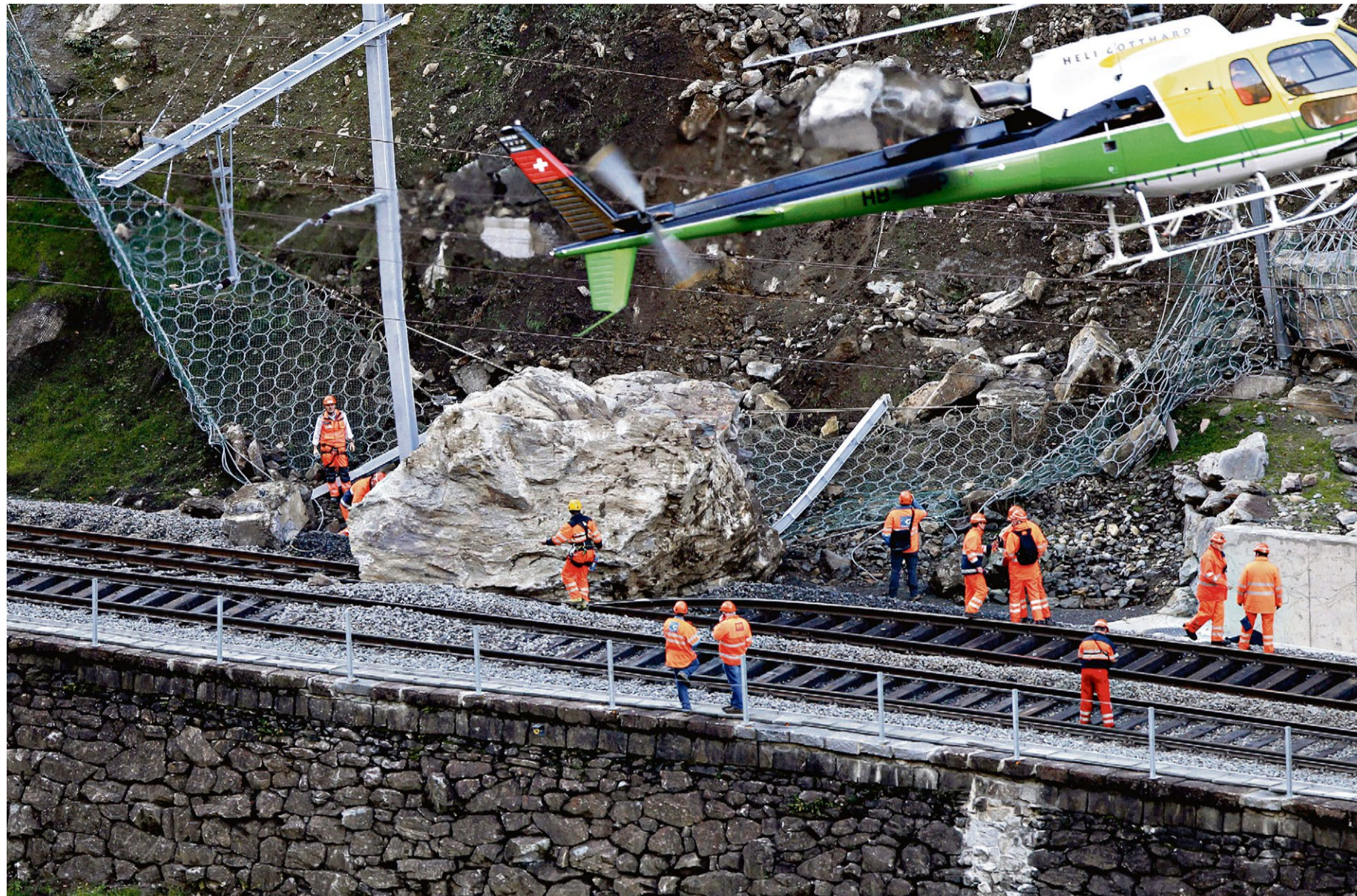
Un important éboulement survenu dans le canton d'Uri, sur un tronçon de la ligne du Gothard. Un tiers du réseau CFF est jugé vulnérable aux risques naturels. (GURTNELLEN, 15 NOVEMBRE 2012/URS FLUEELER/KEYSTONE)
