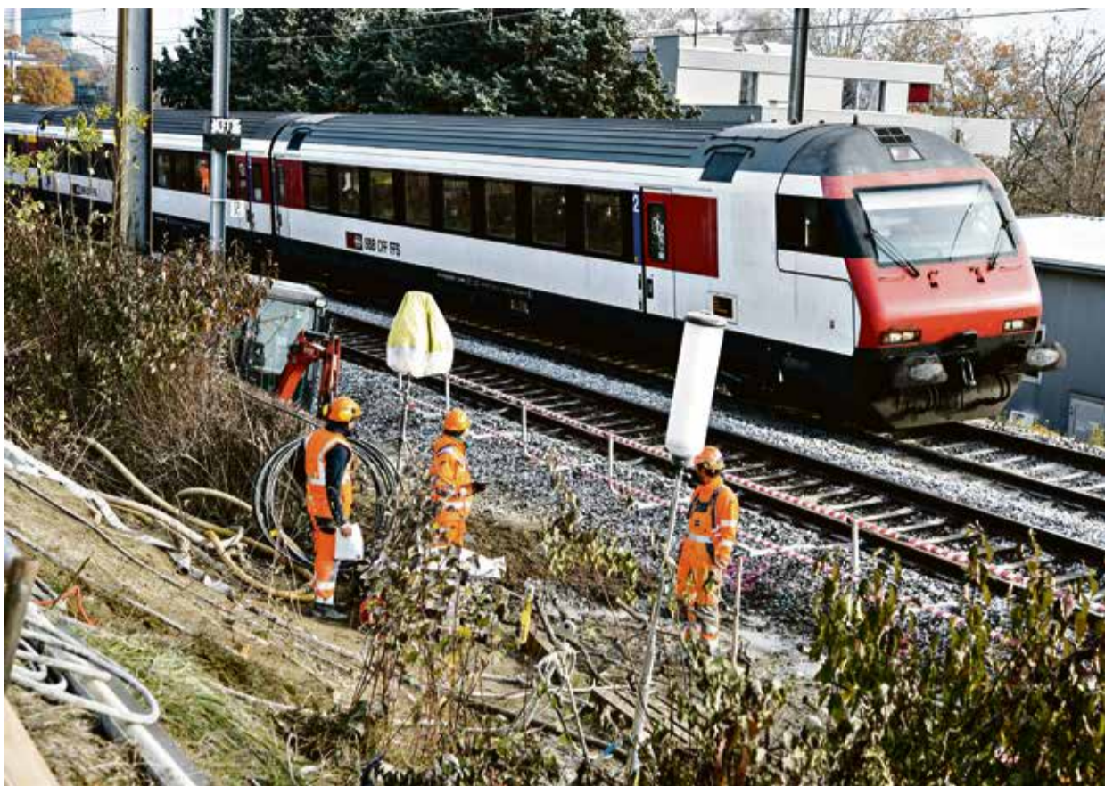
Sur le chantier de comblement du désormais fameux trou, un train passe au pas. (EDDY MOTTAZ/LE TEMPS)
