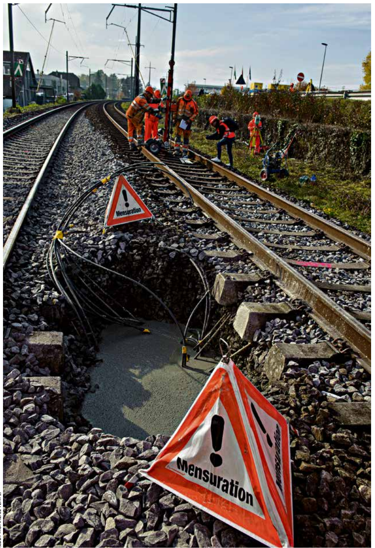
RAIL La liaison ferroviaire entre Lausanne et Genève a été gravement perturbée en raison d'un affaissement de terrain à Tolochenaz. En cause: la pose d'une conduite souterraine destinée à acheminer l'énergie issue du Lac Léman. Le trafic ne sera pas rétabli avant vendredi. Récit d'une journée de gabegie qui a viré au cauchemar pour de nombreux usagers du train.
