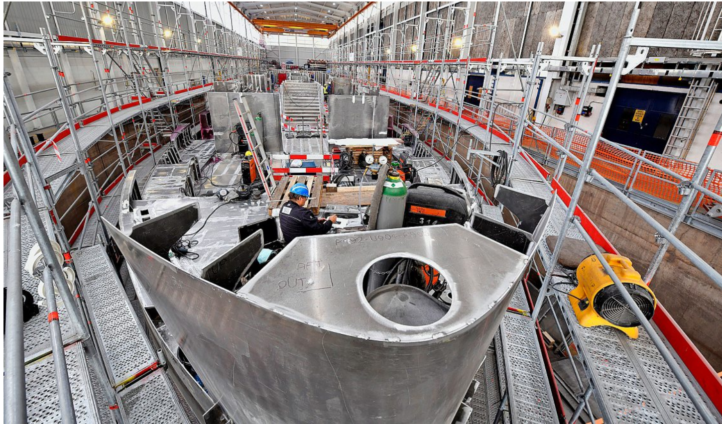
À Ouchy, la halle du bassin de radoub a dû être agrandie pour la construction du Naviexpress.
