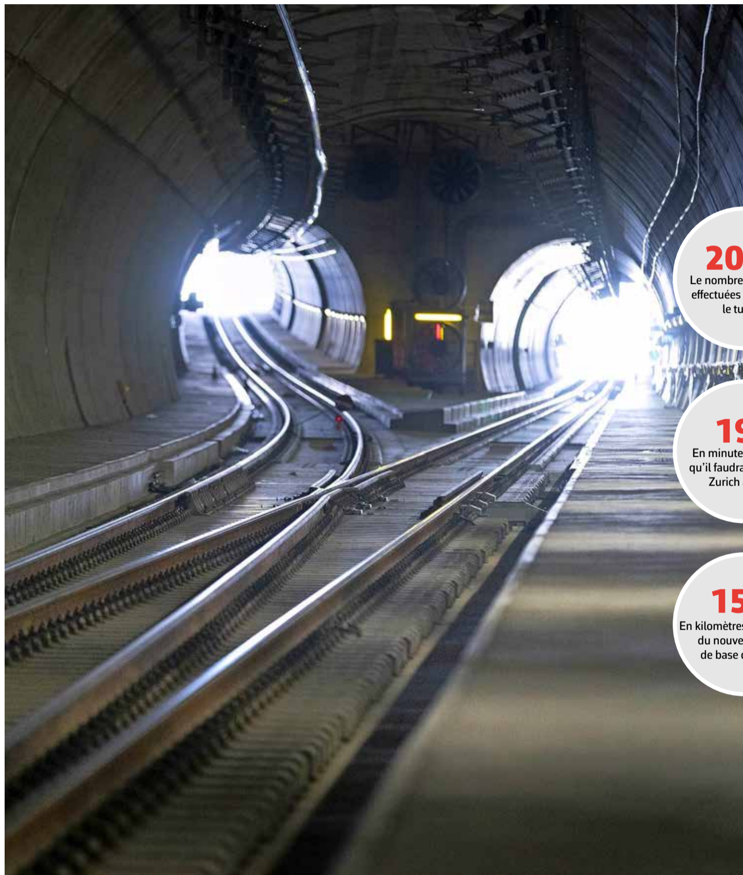
Le premier train régulier du trafic grandes lignes qui traversera le tunnel de base du Ceneri est attendu le 13 décembre. Keystone
