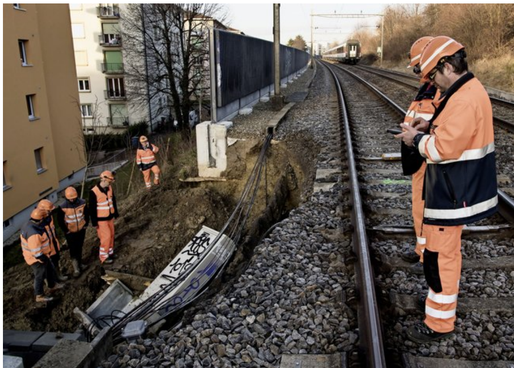
Géologues et ouvriers évaluent les dégâts provoqués par le glissement de terrain.
