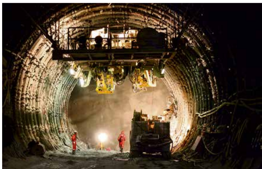
Sedrun, 2005. Les parois du tunnel sont renforcées avec des tenons de métal et du béton. (KEYSTONE)
