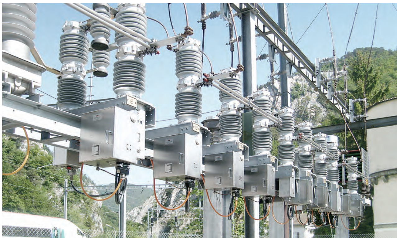
ABB a développé des modules moyenne tension livrés prémontés et testés en usine pour des systèmes d'alimentation électrique pour la traction. Les chemins de fer suisses CFF font partie des premiers clients utilisant cette solution qui offre un important gain de temps (© ABB)
